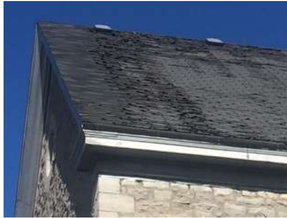
État de la toiture du transept nord
