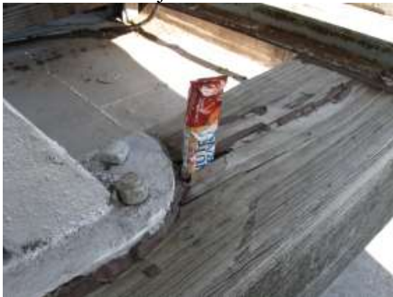
Craques dans les poutres qui supportent les cloches
